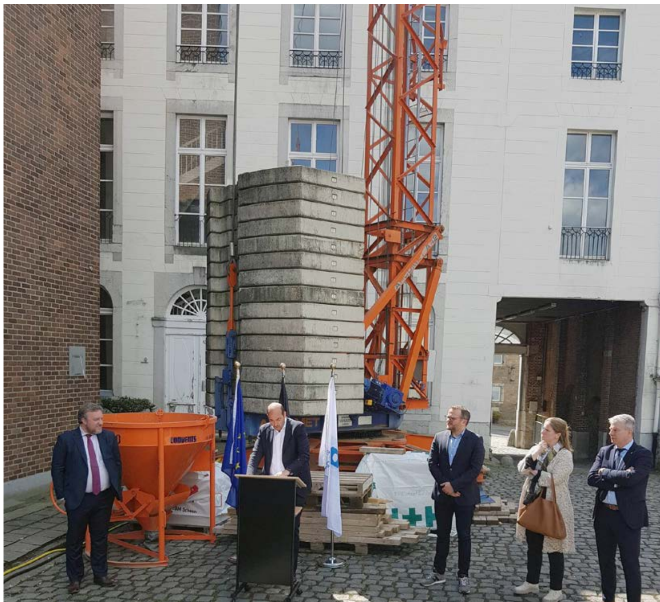
Lancement officiel du chantier du nouveau complexe des Archives de l'État à Eupen, le 21 avril 2023. © Régie des Bâtiments.
