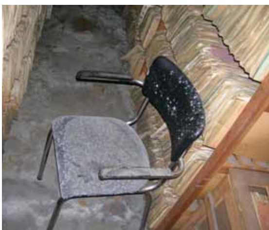
Infestation de locaux et du mobilier par des moisissures
